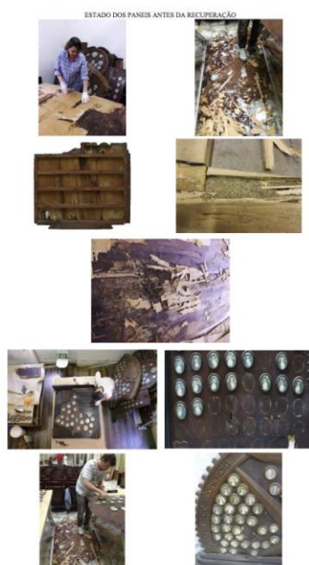
Figura 5. Painéis em estado original (2013) , antes de recuperação, em que se observa o estado de degradação. Acervo MESAC.
